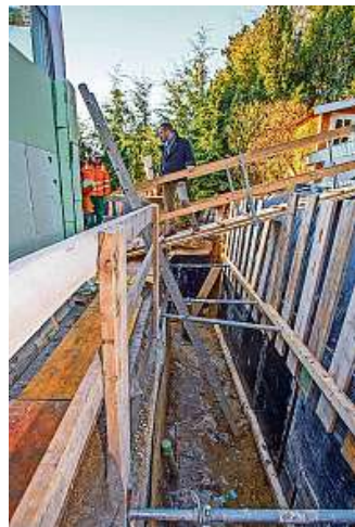
Im Winter klafften hier noch metertiefe Schächte zur Behebung der Schäden.
