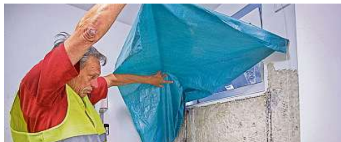
Feuchte Außenwände waren die Folge von Bauplanungs- und Überwachungsfehlern in der Vergangenheit. Hier zu Beginn der Sanierungsarbeiten im September 2019.
