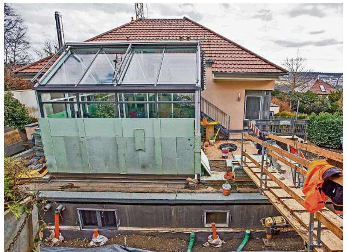
Noch ist das Gelände des Hospizes eine Großbaustelle. Hinter dem Wintergarten klaffen Gräben. FOTOS: MEYER/BAUMGÄRTEL
