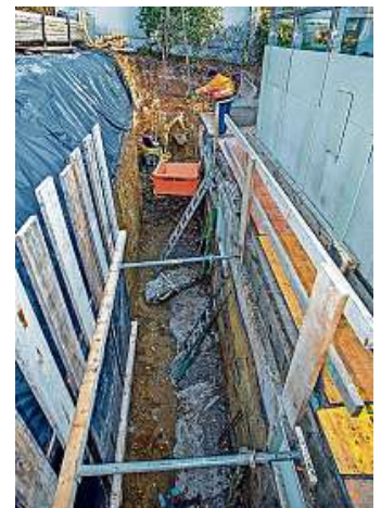
Das kostet Zeit: Mit dem Kran wird das Material an- und abtransportiert.
